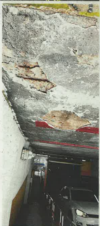
El techo del parking presenta un gran deterioro, como se observa en la imagen. :: V. V. / AGM
